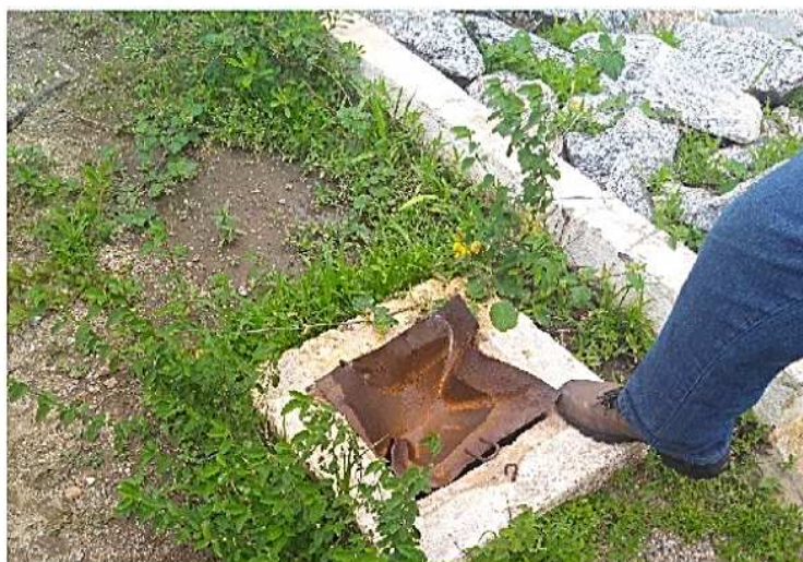
Figura 15 – Tampas das caixas dos piezômetros danificadas (Data da imagem: 30/01/2018)
