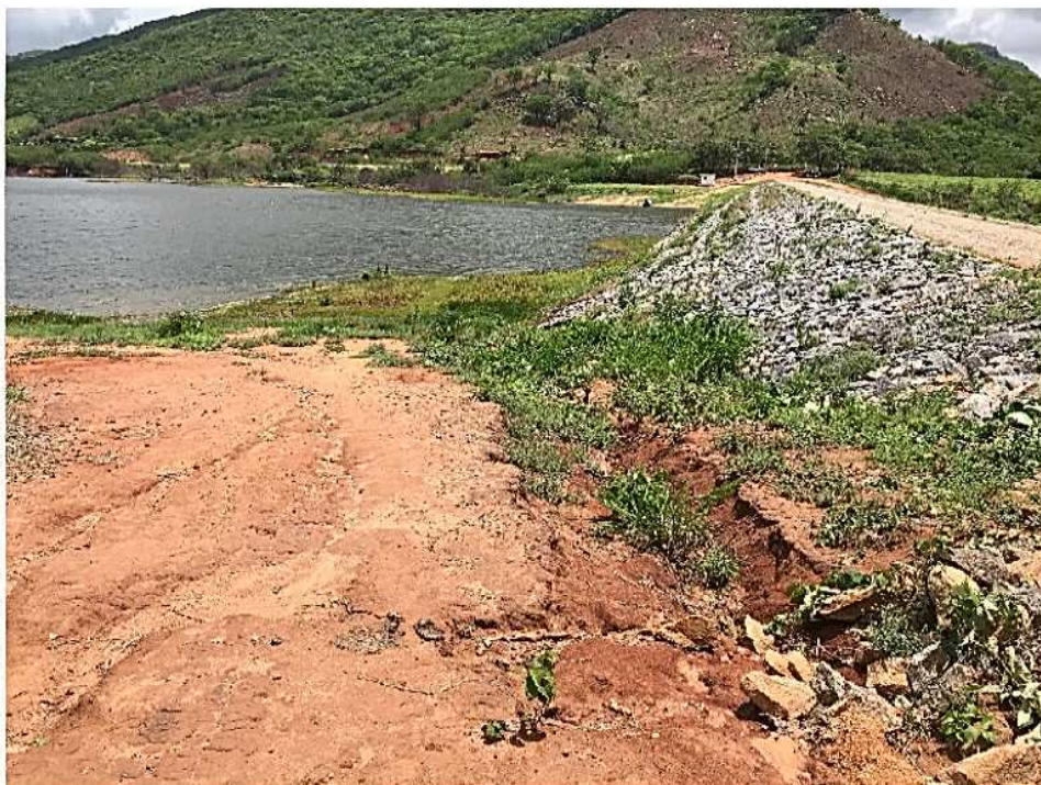
Figura 8 – Erosão na ombreira direita do talude de montante da barragem auxiliar (Data da imagem: 30/01/2018)
